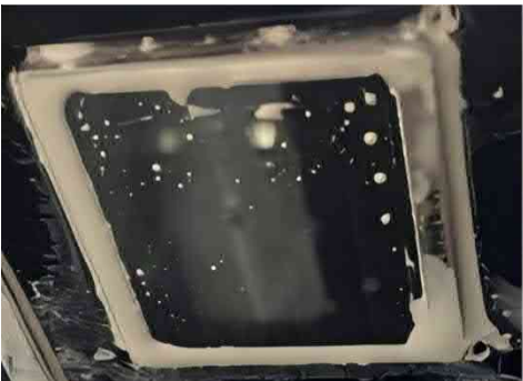
清理前（Before cleaning）
