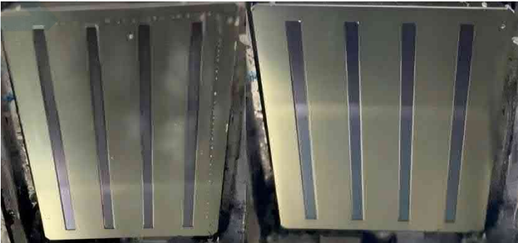
清理前（Before cleaning）
