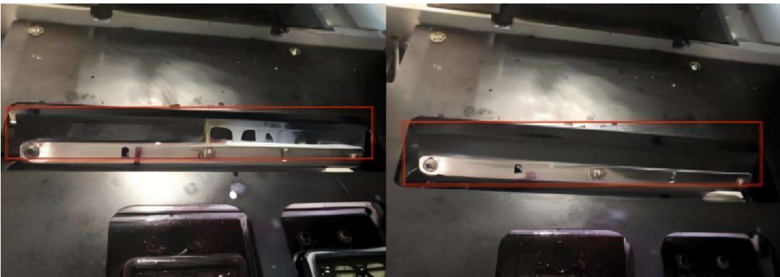
清理前（Before cleaning）
